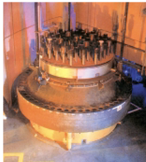
Les plus grands couvercles de cuves mesurent 5,70 m de diamètre.
